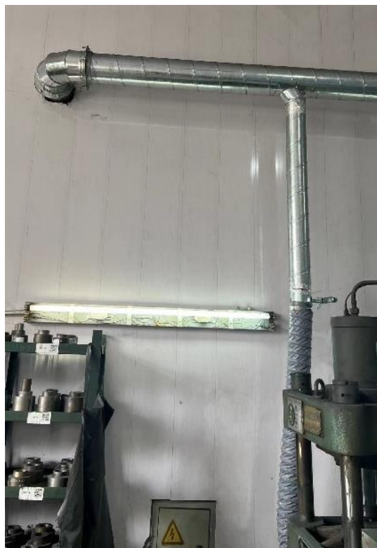
图 3.1-5 压制废气收集装置
