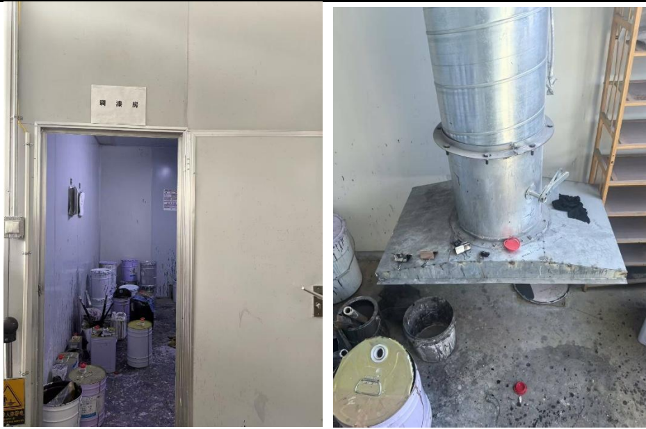
图 3.1-9 调漆房对应废气收集装置
