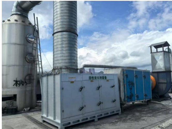
图 3.1-10 油性漆废气处理设施 TA001
