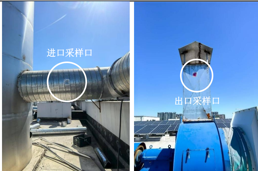
图 3.1-14 废气排气筒 DA003 进口、出口采样口
