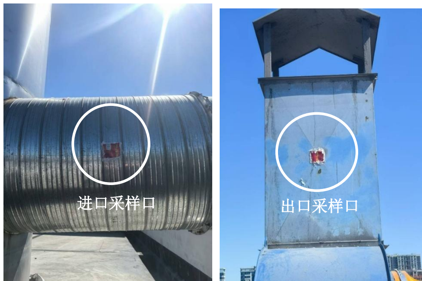
图 3.1-11 废气排气筒 DA002 进口、出口采样口
