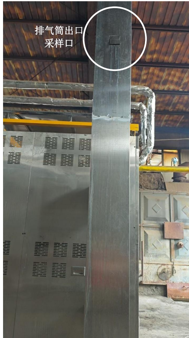
图 3.1-4 天然气锅炉废气排气筒
