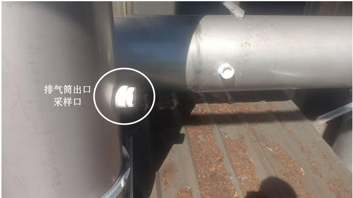
图 3.1-3 废气处理设施采样口
