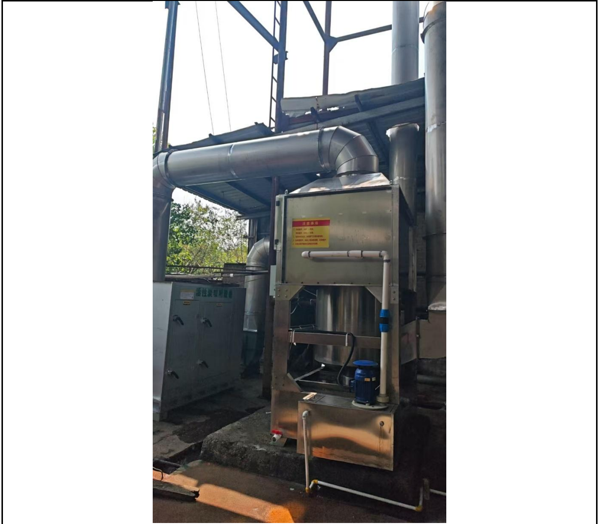
图 3.1-2 烧毛废气对应废气处理设施
