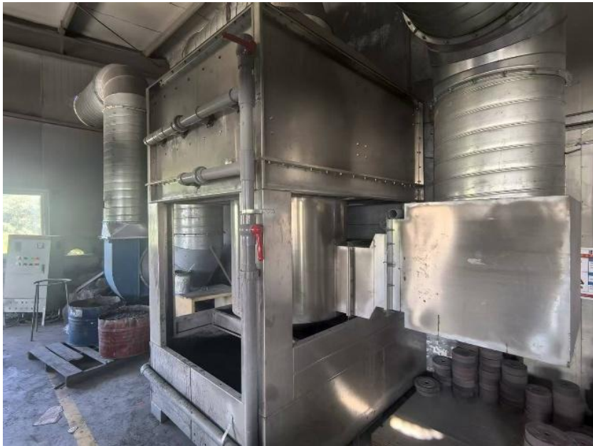
图 3.1-4 水喷淋塔净化装置
