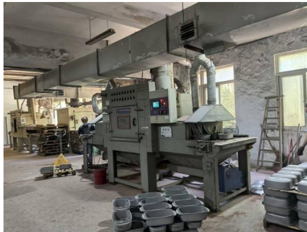
图 3.1-1 过道式喷砂机及对应废气收集装置
