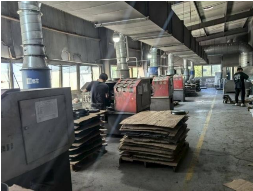
图 3.1-3 抛光机及对应废气收集装置
