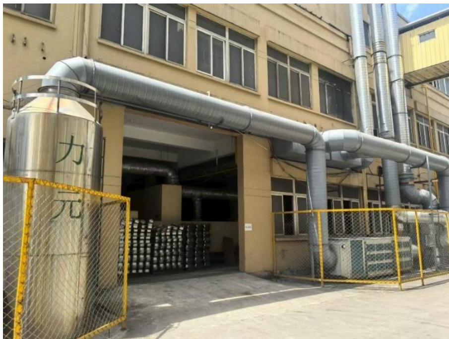
图 3.1-13 天然气燃烧废气、固化烘干废气对应废气处理设施
