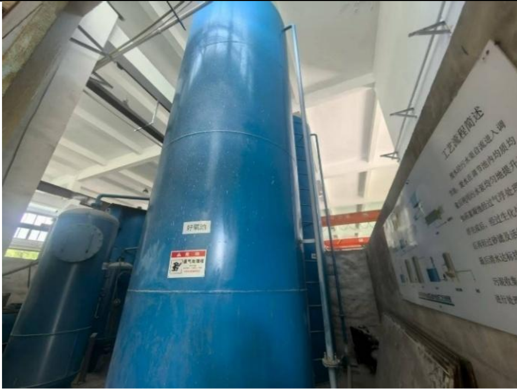
图 3.2-1 厂区内废水处理设施
