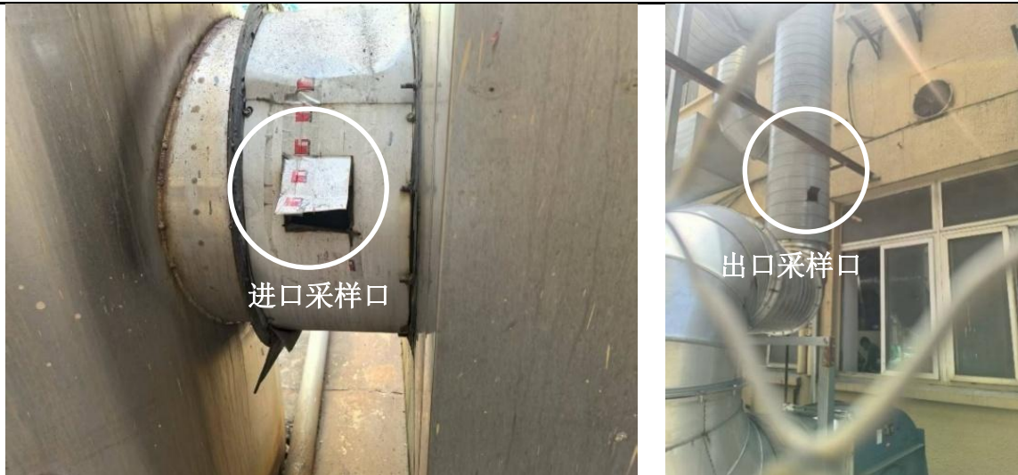
图 3.1-14 废气处理设施进口及出口采样口
