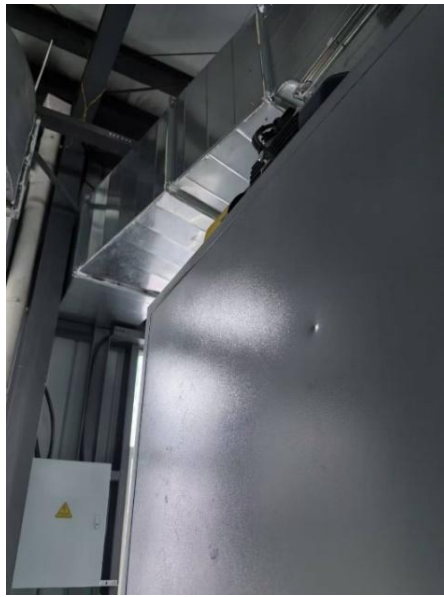
废气收集管道
