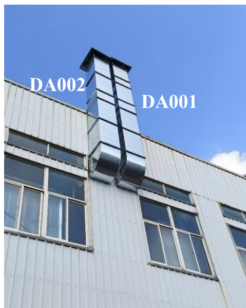
油漆废气排气筒
