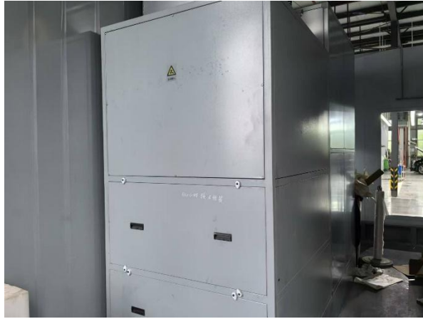
活性炭吸附箱 2#（第二阶段建设）
