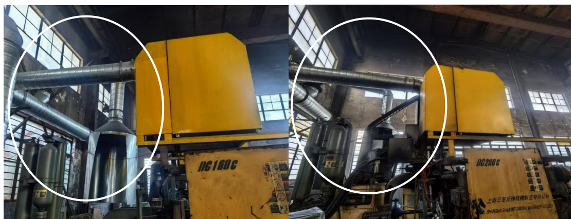
熔化废气收集装置
