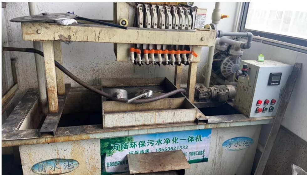
图 3.2-2 废水处理设施
