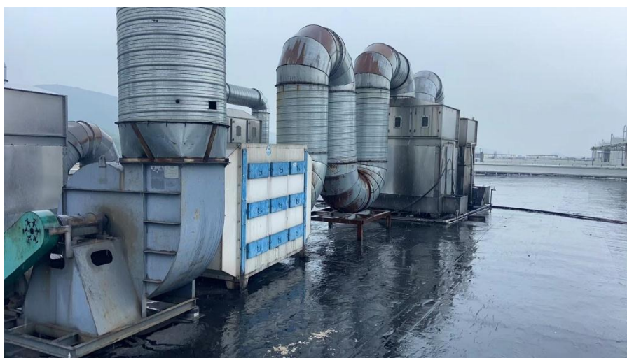
图 3.1-2 废气处理设施 2#现场照片
