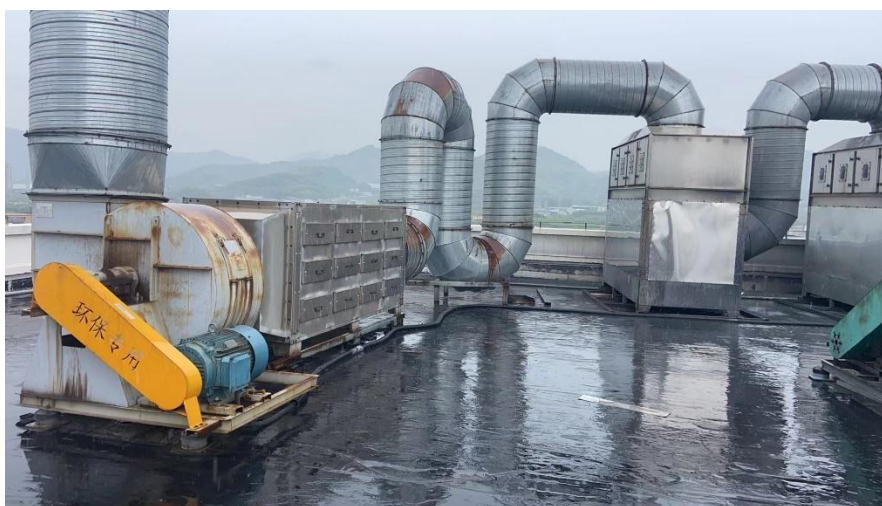
图 3.1-1 废气处理设施 1#现场照片
